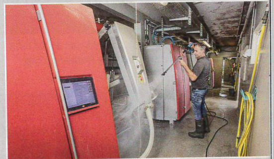
Für den Gang hinter den Melkboxen haben die Tombergs in zwei Zapfstellen investiert.
