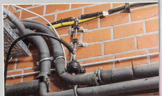
Der Druckspeicher verhindert ein lautes Schlagen beim Schließen der HD-Pistole.
