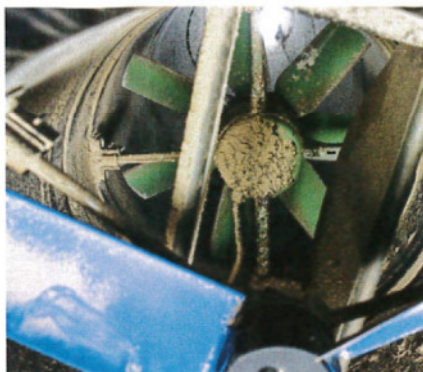
Stark verschmutzter Abluftschacht vor der Reinigung.
