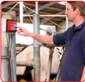
Zentrale Steuerung für den Milchviehstall.
