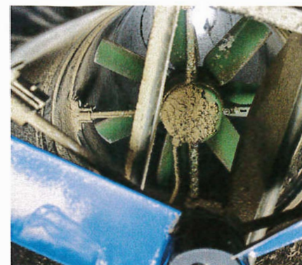
Stark verschmutzter Abluftschacht vor der Reinigung.
